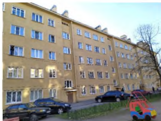
На фото: Рабфаковская ул., д.3 к.2, где подрядчиком не выполнены работы по ремонту фасада
