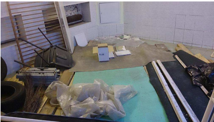
Состояние помещения ветеринарной станции Адмиралтейского, Московского и Центрального районов Санкт-Петербурга, ул.Боровая, д.14 на момент контрольного мероприятия (сентябрь 2015 г.)
