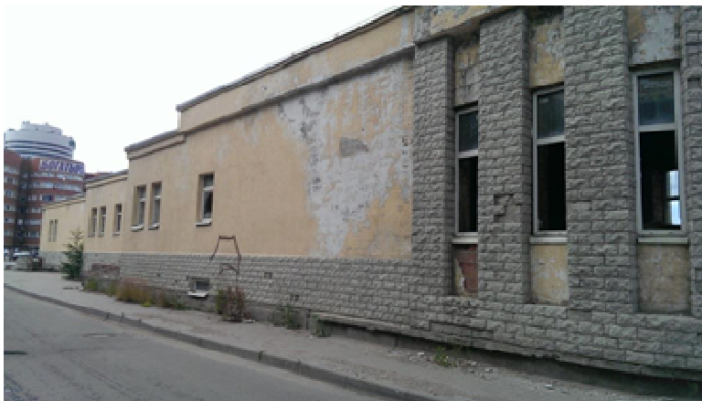
Состояние административно-бытового комплекса на Серафимовском кладбище на момент контрольного мероприятия (сентябрь 2015 г.)
