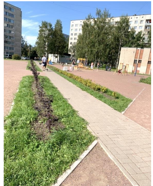
На фото: выполненные работы по устройству новых внутридворовых проездов Колпино, ул. Машиностроителей, д.8
