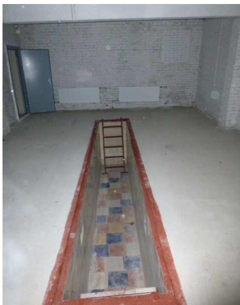
Ремонт гаража в г. Ломоносов, в ходе которого были оплачены фактически не выполненные работы
